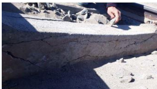
شکل ۱. ترک طولی تراورس بتنی پیش‌تنیده در اثر خوردگی تاندون [5].
